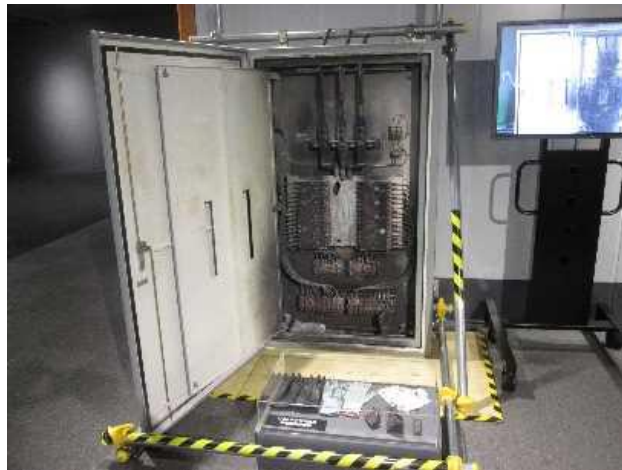
柏崎 5 号炉 定検用分電盤火災
