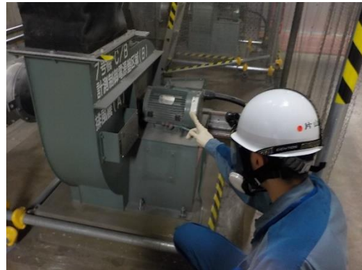
空調機運転状態確認
