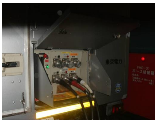
電源車のケーブル接続
