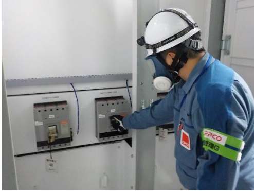
同時投入防止用切替盤
