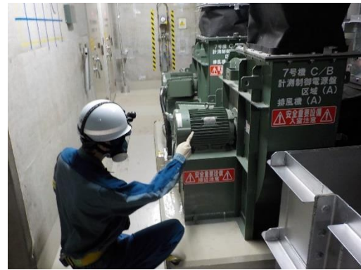
空調機運転状態確認
