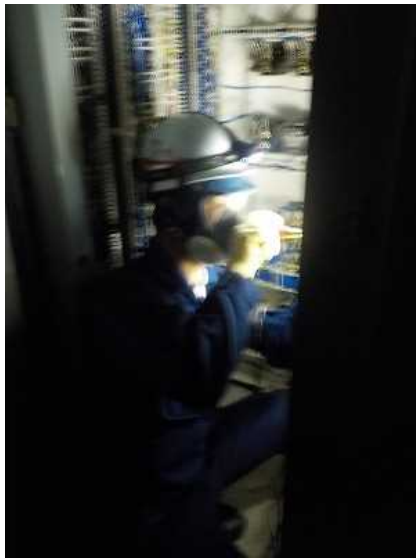
可搬型計測器接続
