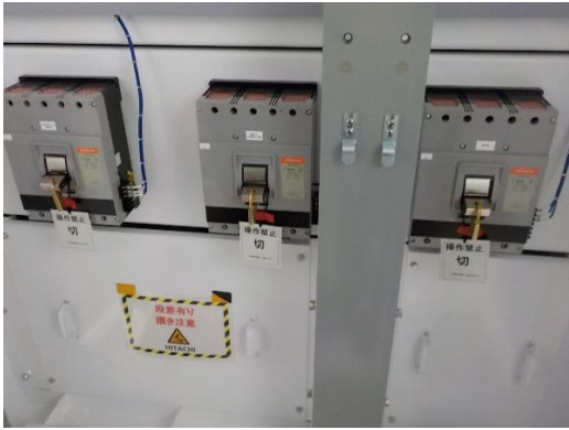
同時投入防止用切替盤
