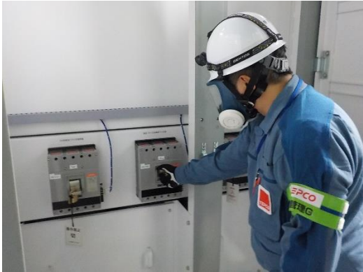
同時投入防止用切替盤
