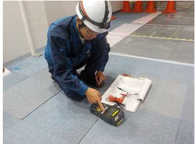
電池容量確認
