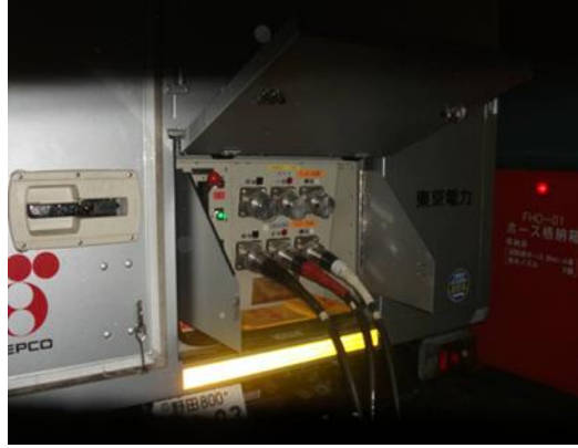
電源車のケーブル接続箇所
