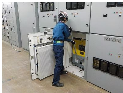
緊急用 M/C 遮断器手動投入
