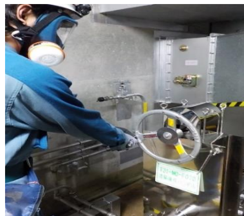
格納容器ベント操作 （遠隔手動弁操作設備）
