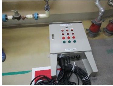
制御盤設置状況
