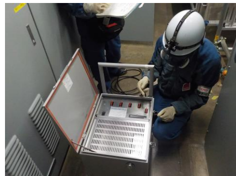
逃がし安全弁用可搬型蓄電池接続
