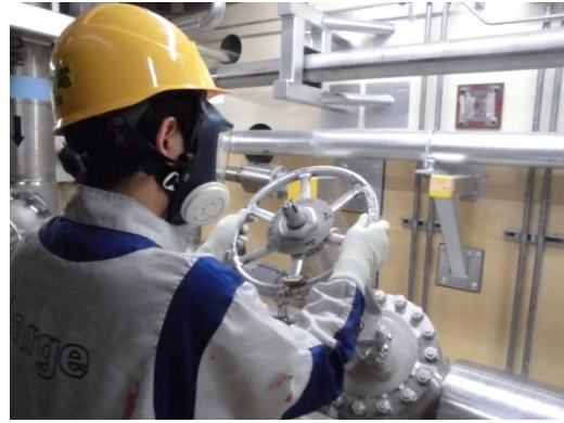
復水移送ポンプ吸込ライン切替え
