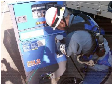
発電機設置状況
