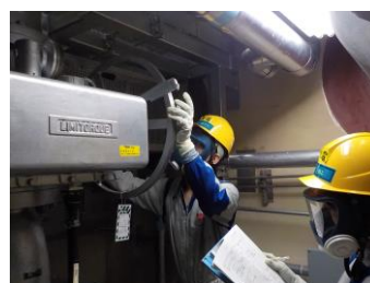
高圧代替注水系 起動操作
