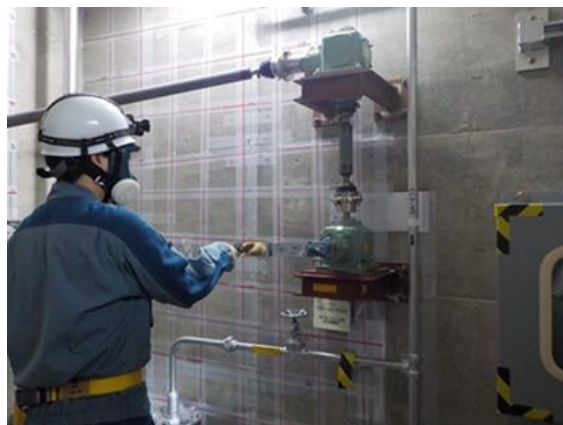
ベント操作（遠隔手動弁操作設備）
