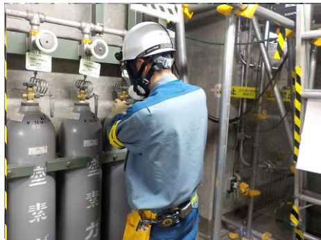
窒素ガスポンベ取替え
