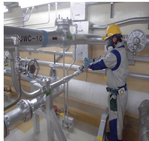
復水移送ポンプミニマム フローライン隔離
