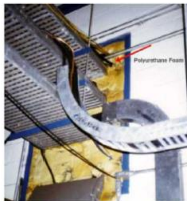
火災の一因となったケーブル・トレイ 貫通部のシール材の例
