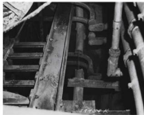
火災後のケーブルトレイ、電線管
