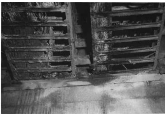
ケーブル処理室から原子炉建屋への ケーブルトレイ貫通部
