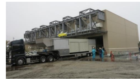
ガスタービン発電機
