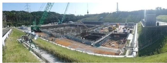
緊急時淡水貯槽
