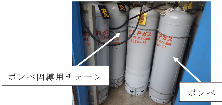
【所内ボイラプロパンガスボンベ庫】LPガス（所内ボイラ起動用）
