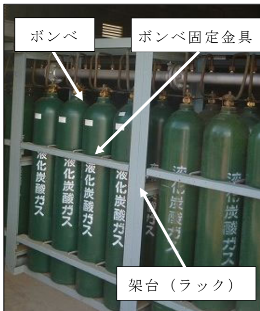
【二酸化炭素消火薬剤貯蔵容器室】 二酸化炭素ボンベ
