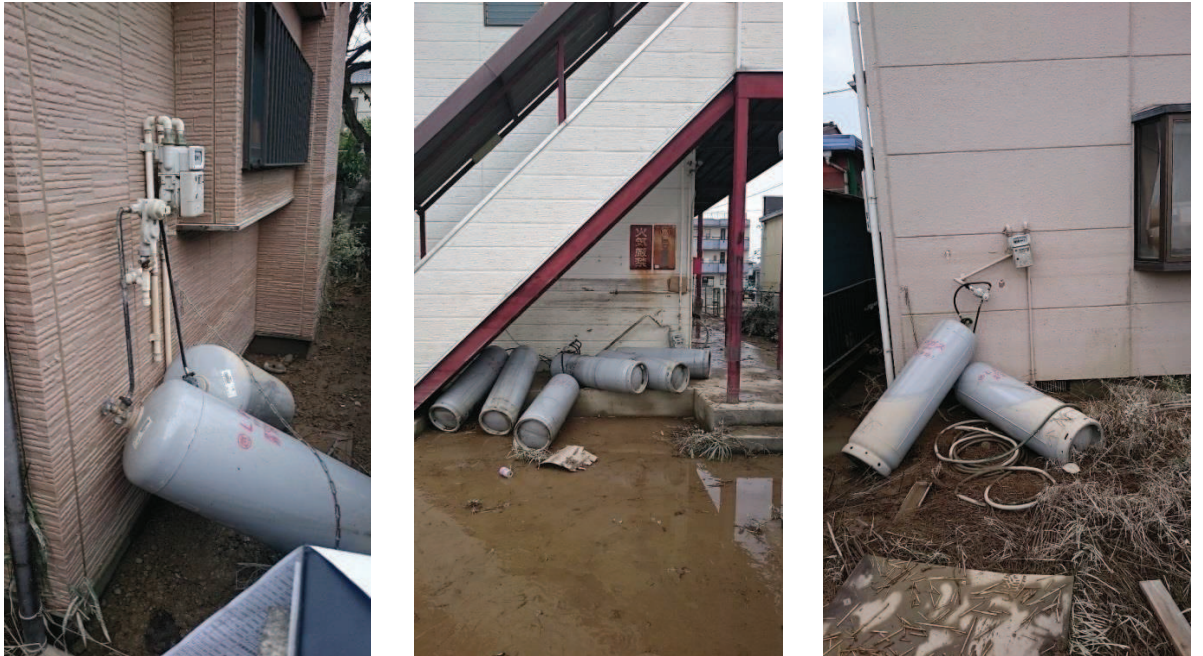
東日本豪雨(常総市の水害)でのLPガスボンベの被災状況の一例 3)
