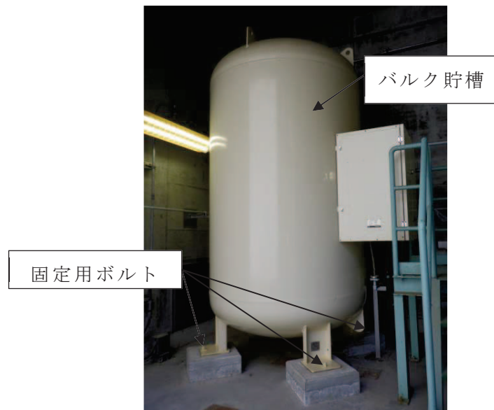
【焼却炉付属棟】 プロパンガスバルク貯槽
