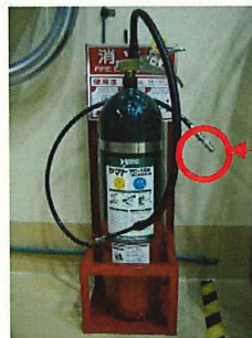
図-2 炭酸ガス消火器
