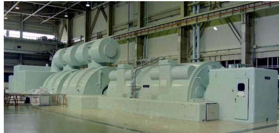
タービン発電機（タービン建物3階）
