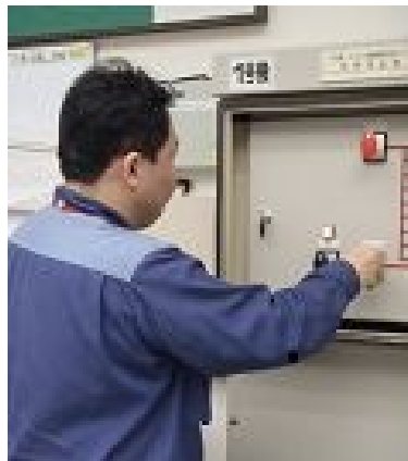
不要直流負荷切離し操作 （中央制御室 操作器）
