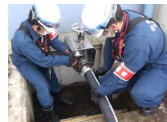
可搬型代替低圧ポンプ接続口 (ホース接続状況)
