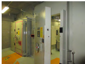
水密扉の設置
