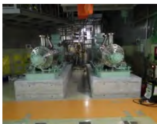
常設代替低圧ポンプ
