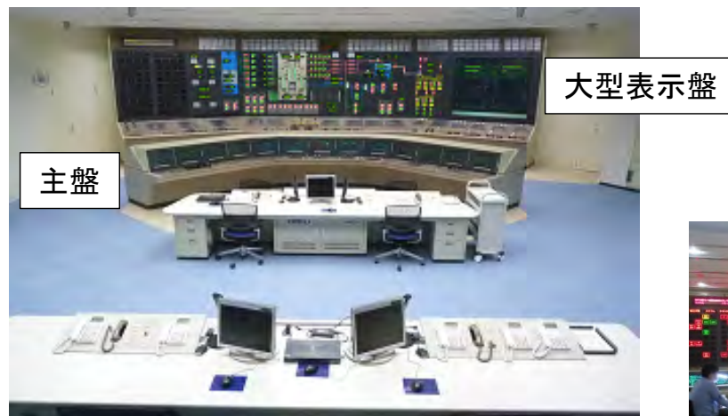
2号機 中央制御室の盤状況※
