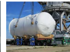
格納容器フィルタ付 ベント装置の搬入 (2015年7月)
