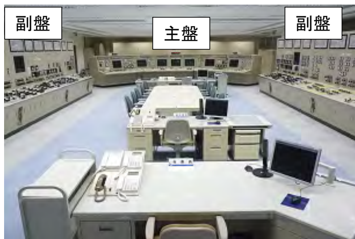
1号機 中央制御室の盤状況※
