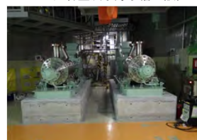
常設代替低圧ポンプの設置
