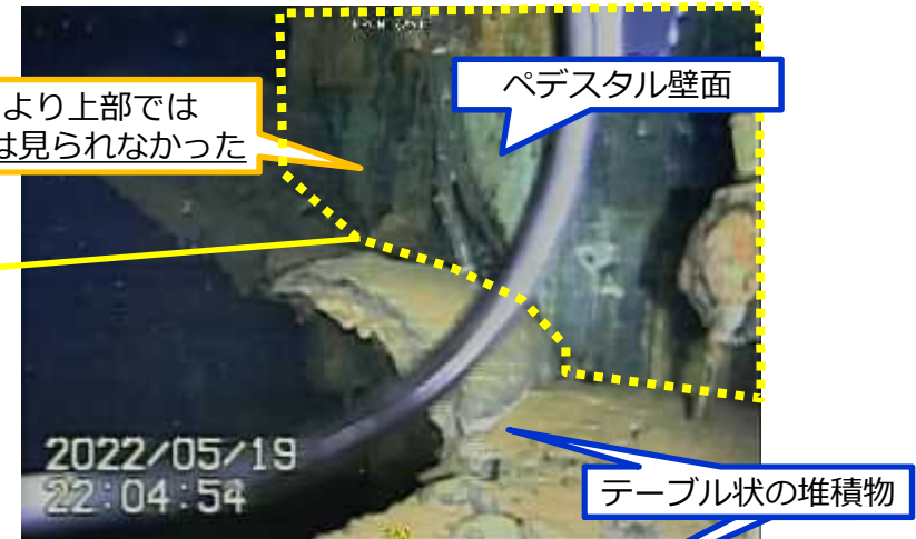
写真2.ペDESTAL開口部(右側基礎部)の堆積物より上部の状況
