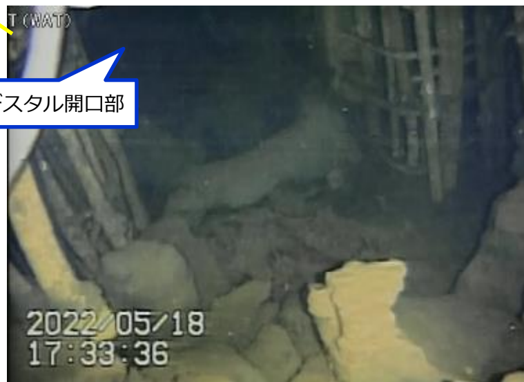
写真3.ペDESTAL開口部前の堆積物の状況
