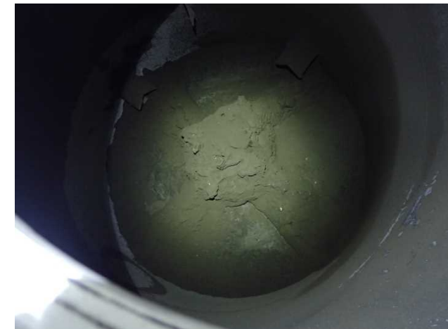
飛灰ホツパ内部の様子
