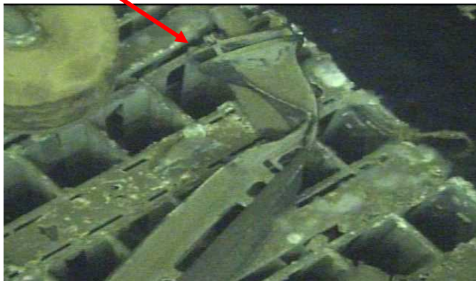
制御棒下部に変形
