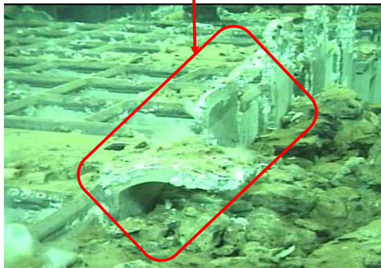
吊りピース変形
