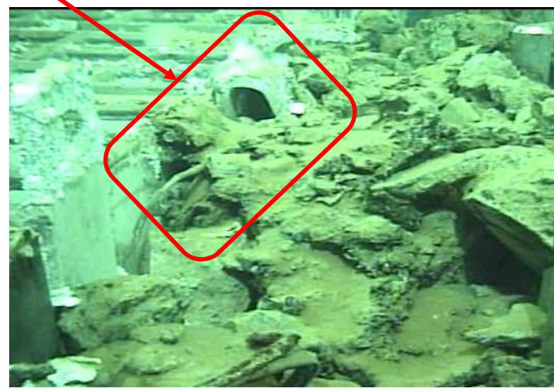
吊りピース変形
