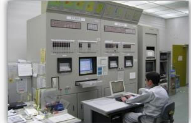
放射線モニタリング (放射線管理用モニタによる連続監視)
