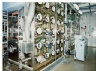
グローブボックス等多数の不稼働設備
