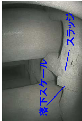
図1 スケール回収画像 (C-SG 第一管支持板) (高浜発電所 4号機前回 (第23回) 定期検査の薬品洗浄前)
