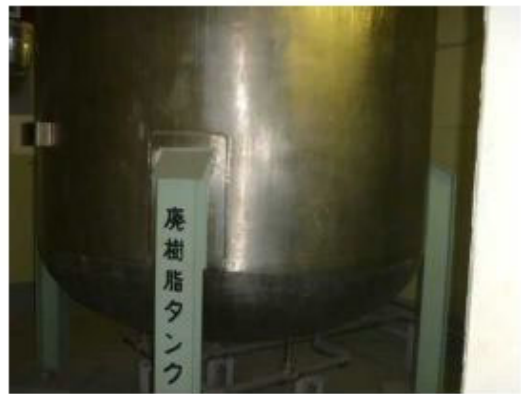
廃樹脂タンク
