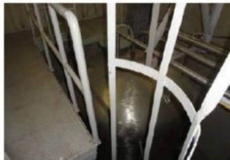
(①廃樹脂貯蔵タンク)
