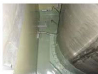
(②廃樹脂供給タンク 下部)
