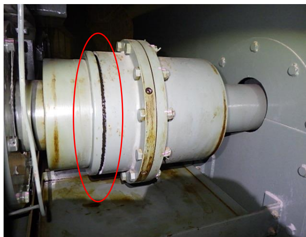
ギアカップリングカバー損傷部
