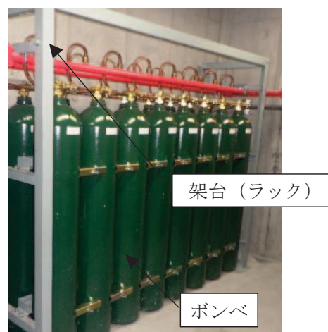
【3号炉原子炉建屋】 二酸化炭素ポンベ
