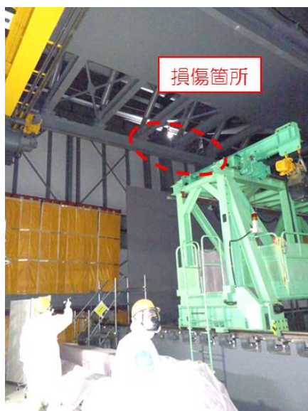
【写真①】 損傷を確認した外壁 (内側から撮影)
