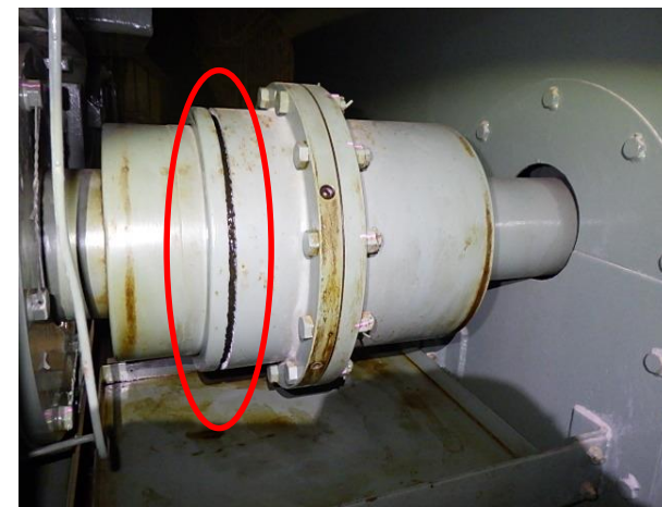
ギアカップリングカバー損傷部
