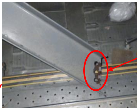
接合部のボルトが破断
