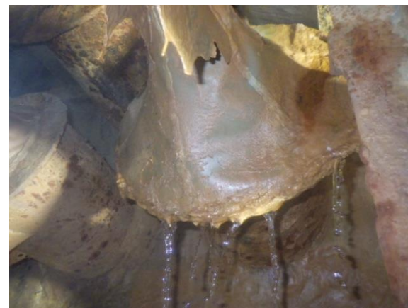
建屋間ギャップ貫通配管部地下水流入状況 (2021.7焼却建屋と工作建屋の貫通配管部)
