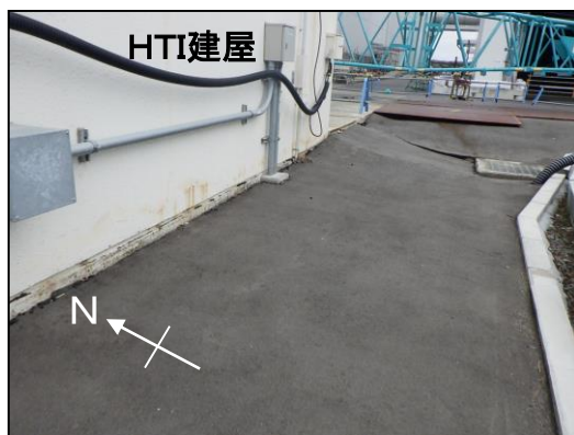
3月19日HTI建屋南側沈下状況
