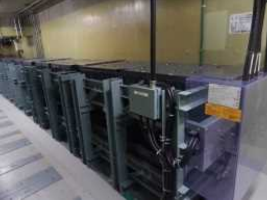
直流電源設備（蓄電池）
