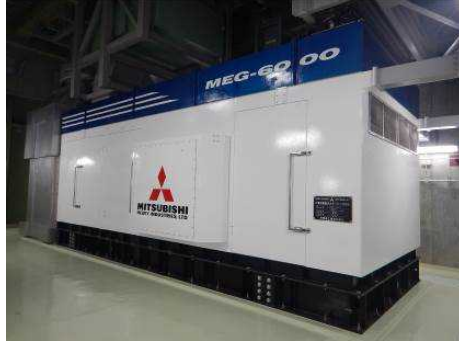
ガスタービン発電機 外観
