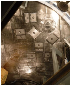
コリウムシールドの設置状況
