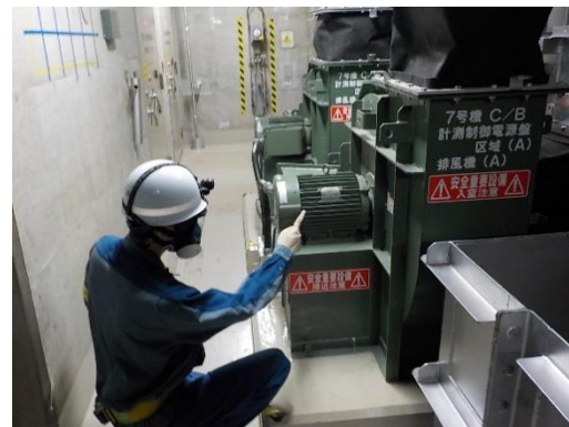
空調機運転状態確認
