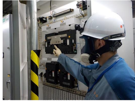
計器電源復旧 (D 系)
