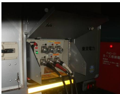
電源車のケーブル接続
