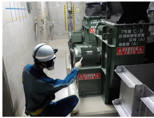
空調機運転状態確認
