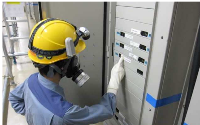
不要直流負荷②切離し操作 (インバータ室)
