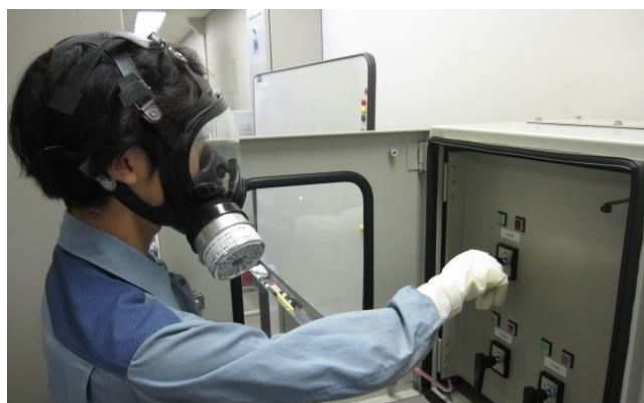
不要直流負荷①切離し操作 (中央制御室)
