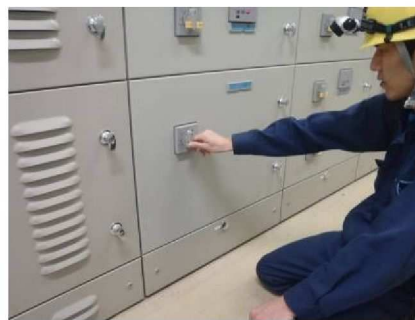
直流電源受電操作 （補助建屋 E.L. +17.0/24.0m）
