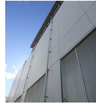
雨水排水設備
