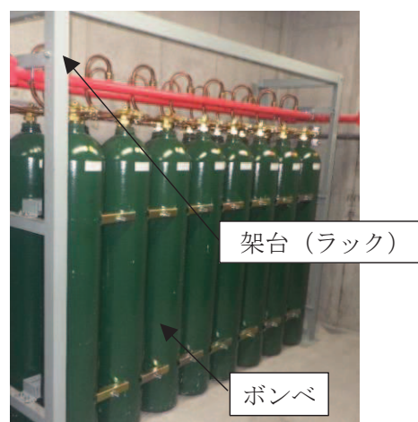
【3号炉原子炉建屋】 二酸化炭素ポンベ
