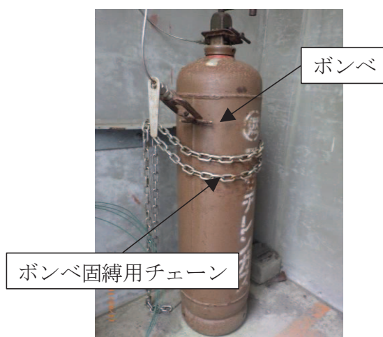
【ガスボンベ庫 (化学分析用)】 アセチレンガスポンベ
