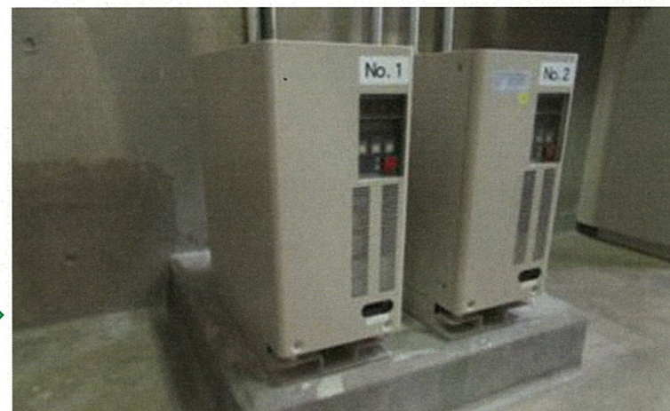
写真：UPS2台の設置状況
