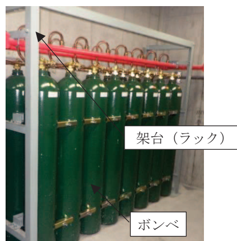
【3号炉原子炉建屋】 二酸化炭素ポンベ
