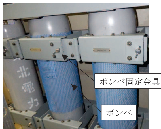
【2号炉原子炉建屋】 酸素ガスポンベ
