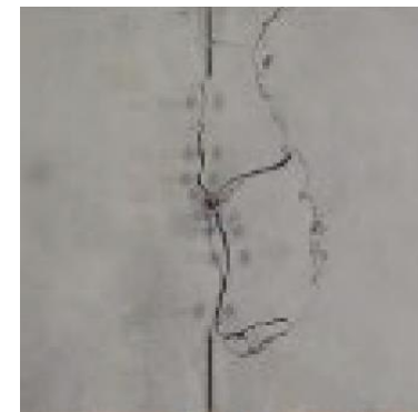
破壊状況（平面）
