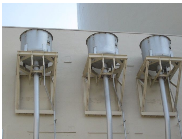
図3 主蒸気逃がし弁消音器の設置状況
