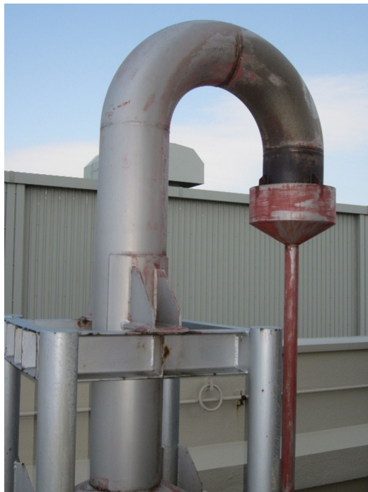
図 1 タービン動補助給水ポンプ蒸気大気放出管の設置状況
