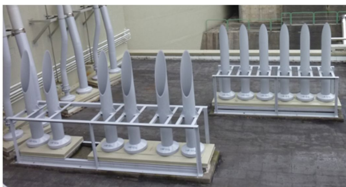
図 3 主蒸気安全弁（排気管）の設置状況（1号炉）
