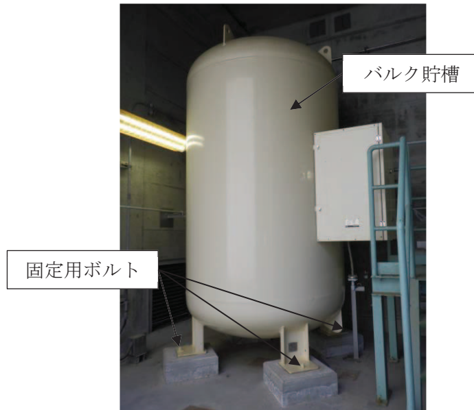
【焼却炉付属棟】 プロパンガスバルク貯槽
