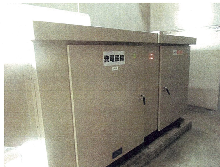
写真：EG 1号機の設置状況
