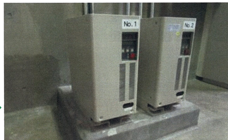
写真：UPS2台の設置状況
