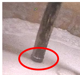
移替え後HICの底部拔出配管
