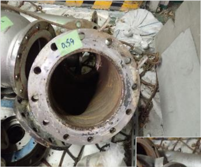
ルーツブロウ出口配管
