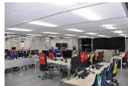
川内 緊急時対策棟 指揮所
