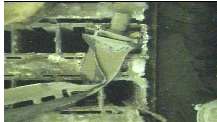
制御棒下部に変形
