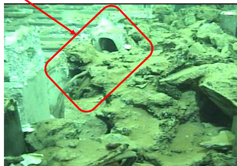
吊りピース変形
