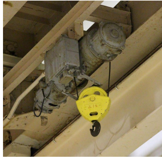
クレーン設備
