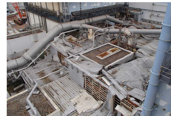
主排気ダクト（東側）
