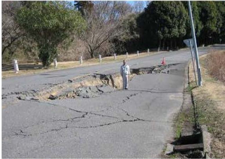
図-4 2011年東北地方太平洋沖地震の被害状況（図-2 ⑬構内道路付近）
