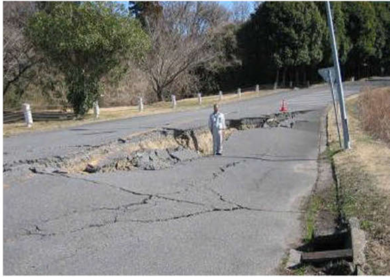
図-3 2011年東北地方太平洋沖地震の被害状況（図-2 ⑬構内道路付近）
