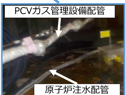
移設対象の重要設備
