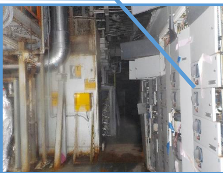
電源盤等の干渉物
