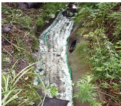
【ストロンチウム除去材設置後の排水枡（7/5撮影）】
