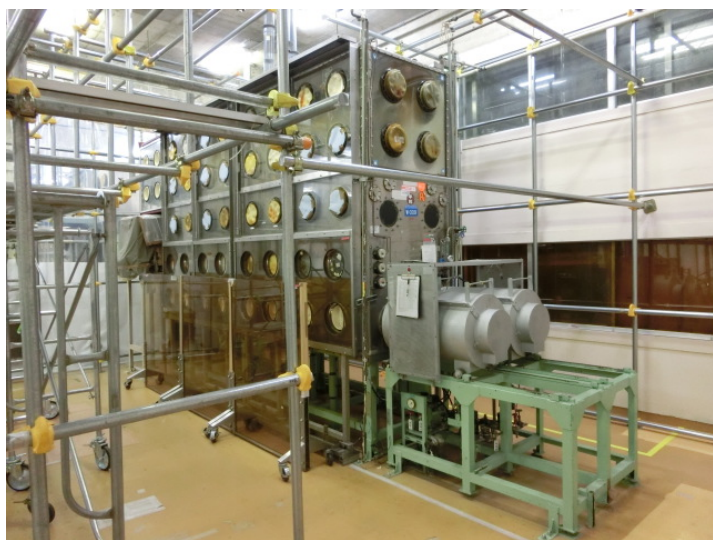
旧焙焼還元炉側から見たグローブボックスNo.W-9
