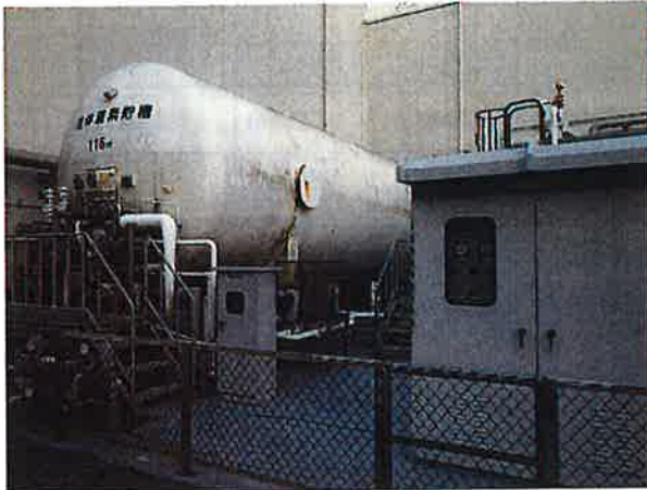
<格納容器内ガス濃度制御系>
