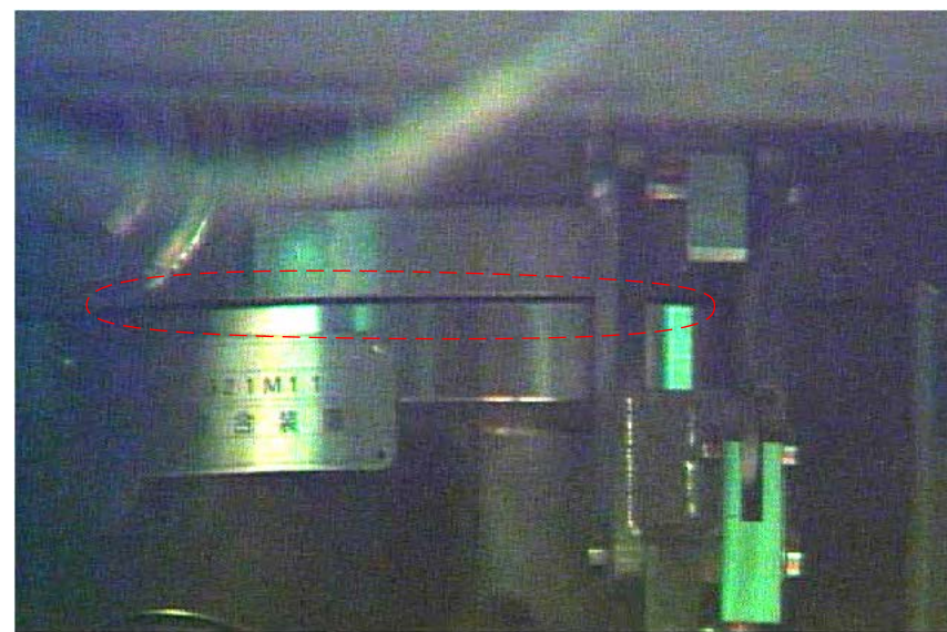
フランジ西側の観察結果 (給電フィーダ側遠隔サポート緩め前)
