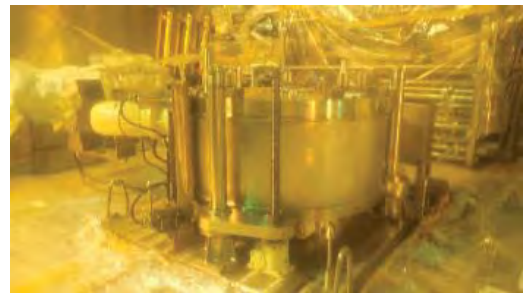
遠隔交換装置全景
