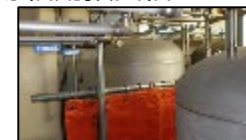
[劣化重水貯槽及び重水貯槽用拔出槽]
