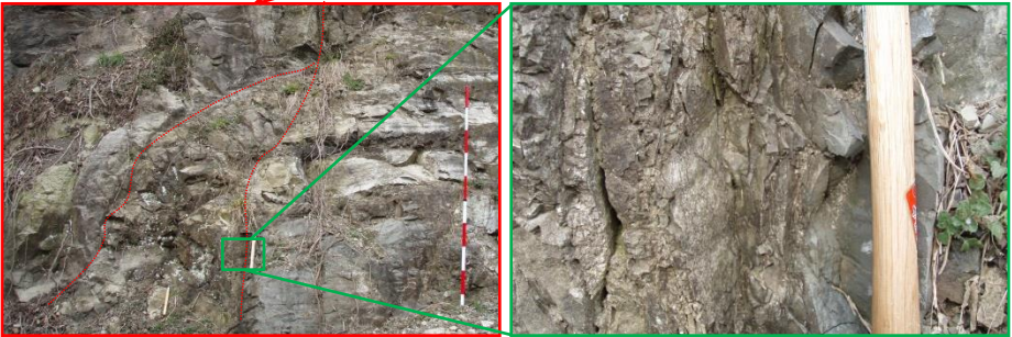
【a断層】 ・ N40E/85NWの走向傾斜を示す。 ・断層沿いには、ガウジや角礫部は認められず、固結・密着している。
